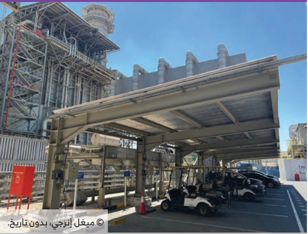
الشكل ٤/٨١: محطة شحن للمركبات الكهربائية تعمل بالطاقة الشمسية في مصنع ألبا.
